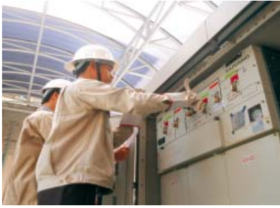
บริการระบบไฟฟ้า
